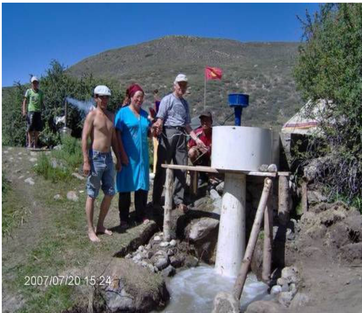
Рис. 6.5 Микро ГЭС низконапорная с вертикальным валом мощностью 1000 Вт на реке Чон Кызыл Су Иссык-Кульской области. Электрическое освещение в Юрте.
